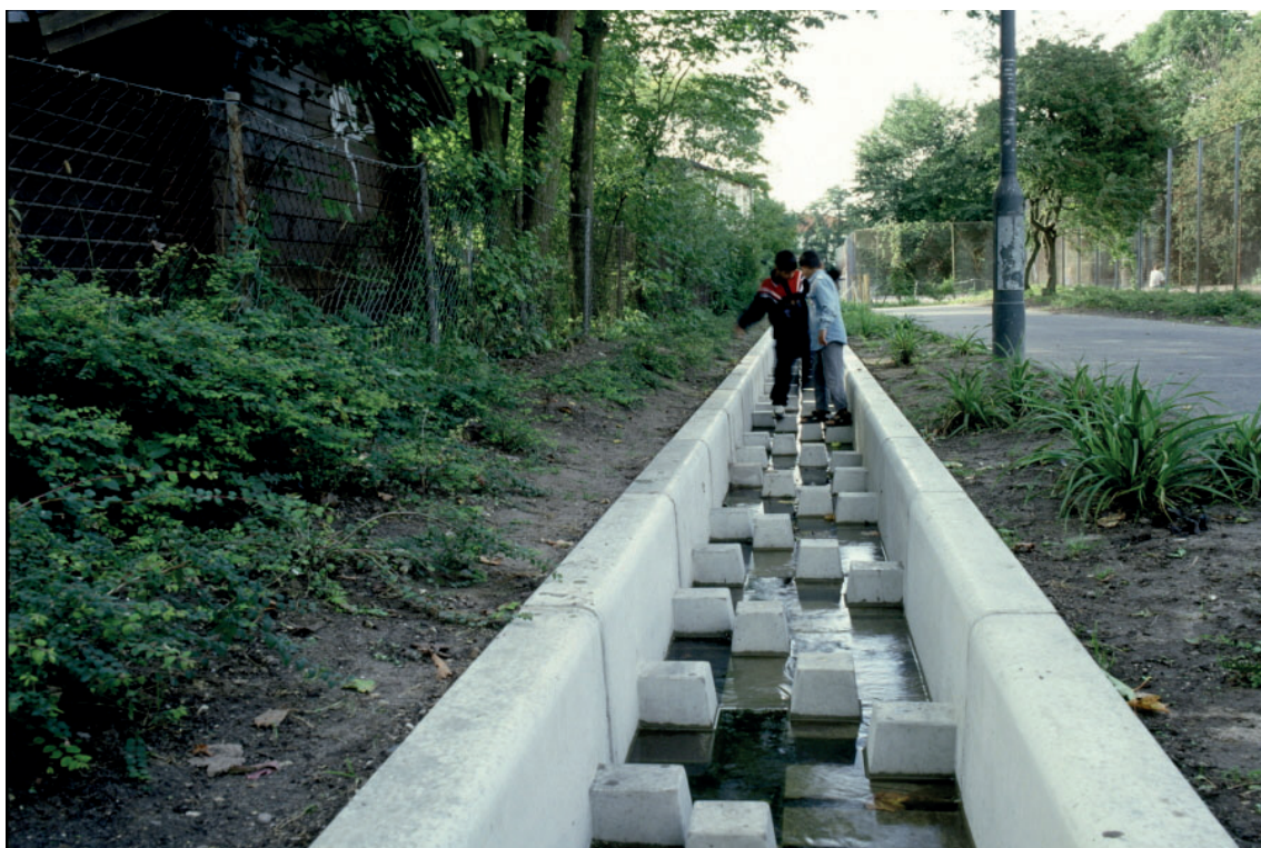
Figur 12: rinnväg i form av en så kallad "kubbäck" för större dagvattenflöden (bild: St. Eriks)
